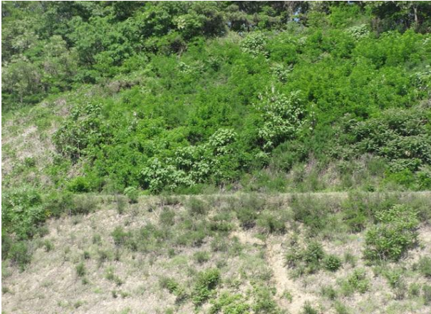
위 치 STA.2+340~430 3단 내 용 와이어로프 녹발생 및 능형망 노출
