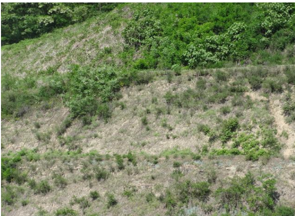
위 치 STA.2+350~420 2단 내 용 와이어로프 녹발생 및 능형망 노출
